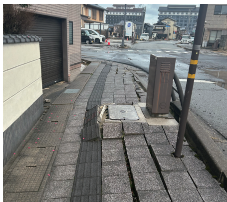
▲液状化により破損した歩道
